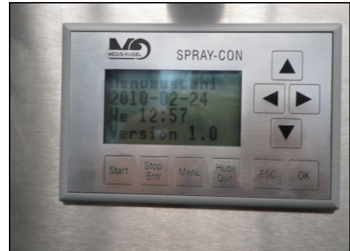
Steuerung der SprayCon-Anlage mit Warn-Meldung
