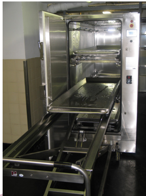
Automatisches Be- / Entladen der SprayCon-Anlage
